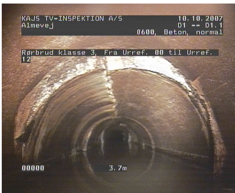
Figur 7: Rørbrud klasse 3, forskudt samling klasse 3. Delstrækningen fra brønd D1 (st. 1786) til brønd D1.1 (st. 1629) /7/.
